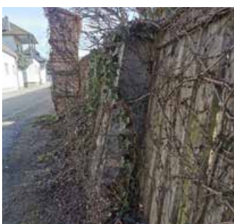
Die Gartenmauer beim gemeindeeigenen Garten Kirchengasse/Venusberger Straße ist einsturzgefährdet und stellt eine Gefahr dar.
