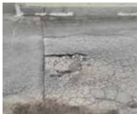
Die Fahrbahnschäden in der Kirchengasse sollten dringend behoben werden.
