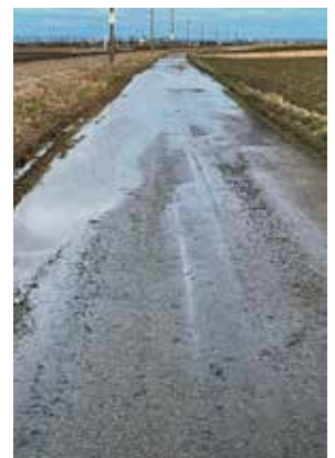
Ausstehende Bankettsanierung durch die ÖBB am Bahnbegleitweg.
